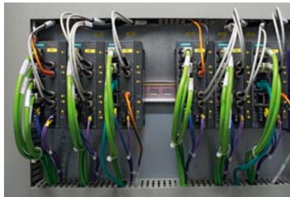
Für höchste Verfügbarkeit ist das Automatisierungs- und Vernetzungssystem umfassend redundant aufgebaut
